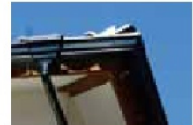
伸縮・膨張で破損しやすい出隅箇所
